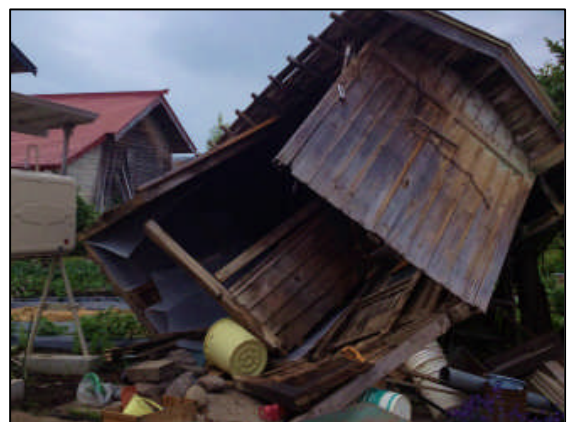
C 6 倒壊した小屋 （南東から撮影）
