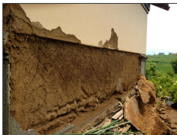
A 2 蔵の南西側壁面剥離 (西から撮影)
