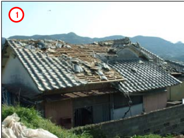
① 南側の瓦が北東方向へ損壊
