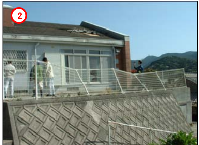
② 公民館 屋根瓦約20枚前後損壊（南側から北側へ） フェンス倒壊寸前（南側から北側へ）
