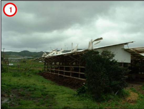
牛舎の屋根の一部が北東側にめくれている。
