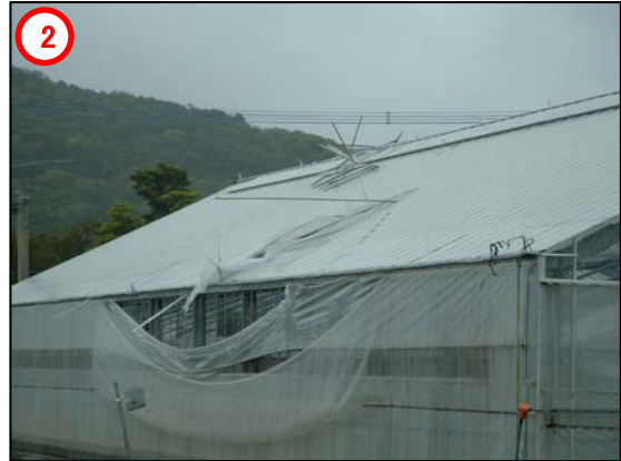
全長 37mのビニールハウスの屋根の天窓が破損し東側のビニールが13mに渡りめくれている。
