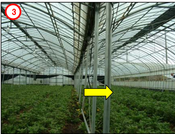
ビニールハウス内の支柱が北側に傾いている。
