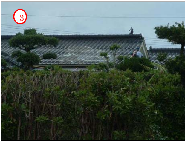
屋根瓦が東方向へ飛散
