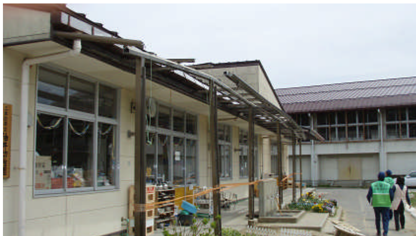
①ー 1 油井幼稚園 アルミ製ひさしのポリカーボネート屋根材が北東に飛散し、50～100m先の田に落ちていた。
