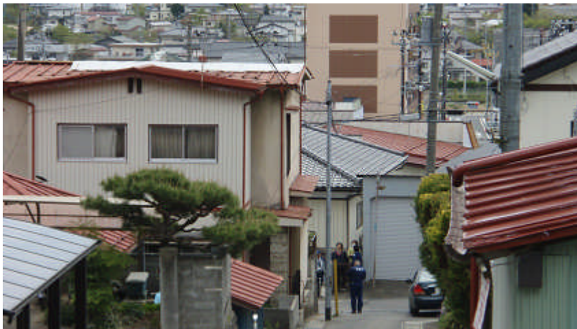
③ 松岡地区 トタン屋根中央部が北に飛散（白いシート部）。 聞き取り：22時30分頃、凄い風の音がし、表札が落ちた。
