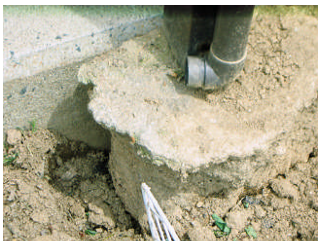
①ー 2 油井幼稚園 ひさしの土台が浮き上がる。
