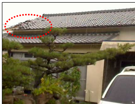
屋根瓦がめくれた住家（今田町今田新田）
