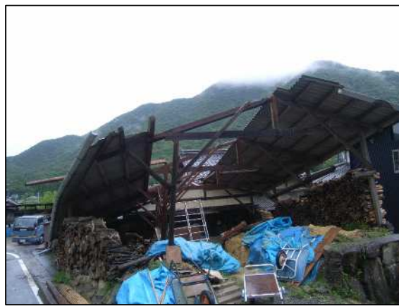
トタン屋根が北方向に倒壊した倉庫（今田町休場）
