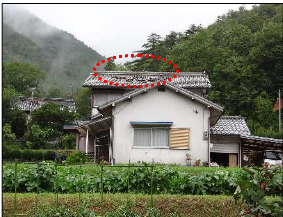
屋根瓦がめくれた住家（今田町休場） 【篠山市提供】
