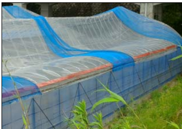
写真⑤ 鋼管(直径30mm)が変形した パイプハウス(南東方向から撮影)
