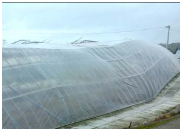
写真④ 鋼管(直径50mm)が変形した パイプハウス(東方向から撮影)
