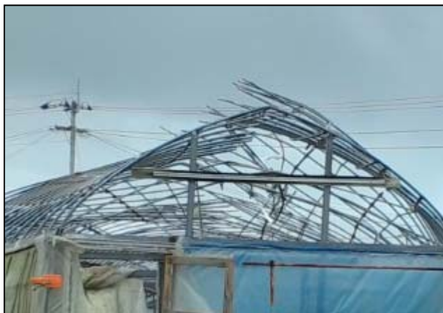
写真③ 鋼管(直径30mm)が変形した パイプハウス(北西方向から撮影)
