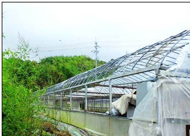
写真② 被覆材がはく離したパイプハウス (南西方向から撮影)
