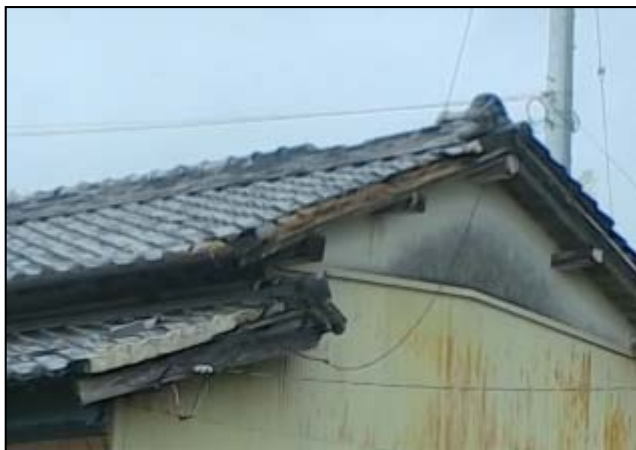
写真① 屋根瓦が飛散した住家 (南東方向から撮影)
