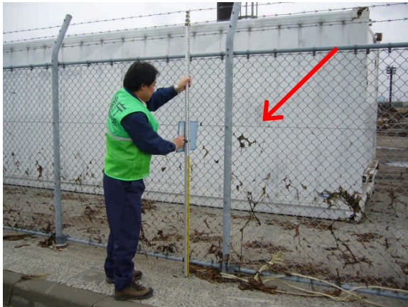
写真1 苫小牧市西港区勇払ふ頭 フェンスに残る津波の痕跡（写真中矢印）。
