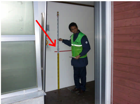
写真3 根室市花咲港区西浜地区ふれあい広場 トイレに残る津波の痕跡（写真中矢印）。
