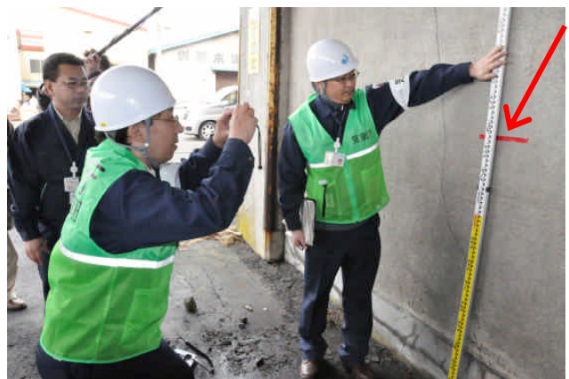
写真6 釧路市東港区副港 壁面に残る津波の痕跡。
