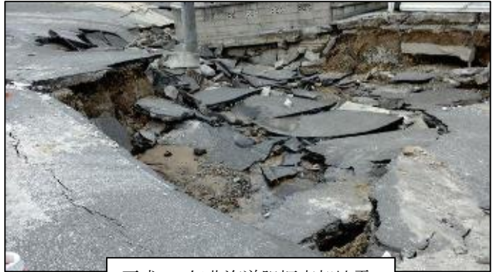
平成 30 年北海道胆振東部地震 市道の損壊 (札幌市)
