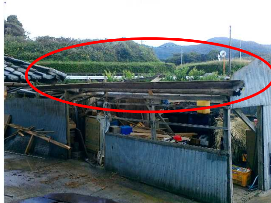
② トタン屋根の剥がれ
