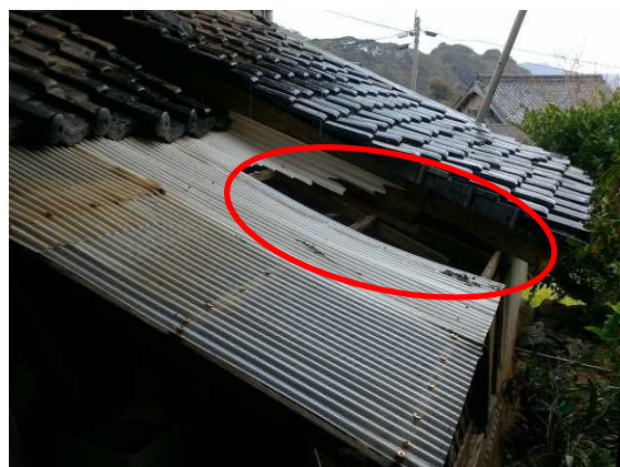
④ 波板（プラスチック）の破損
