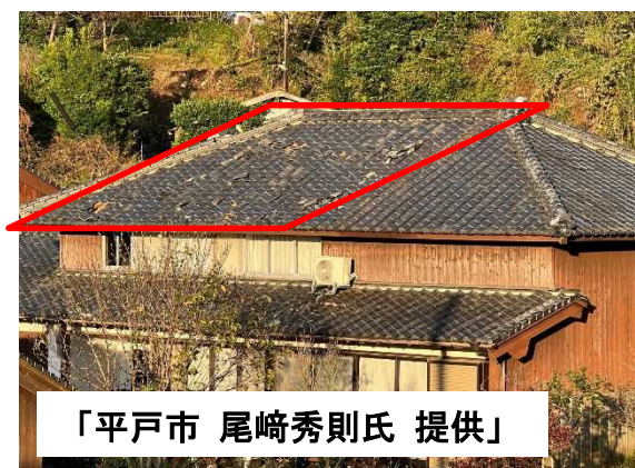
③ 屋根瓦のめくれ
