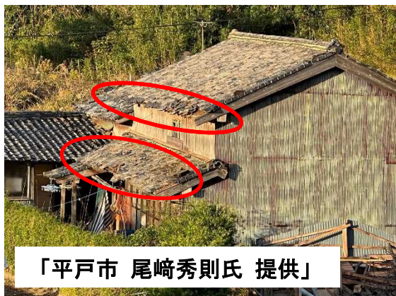
① 屋根瓦のめくれ
