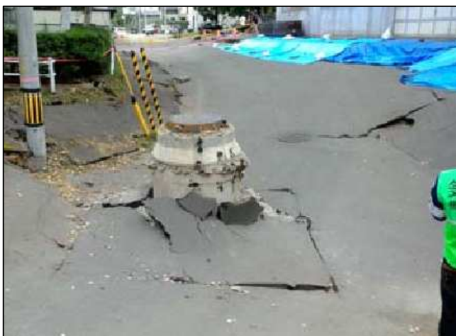
写真1 マンホール周辺の道路の陥没(札幌清田区平岡地区) (平成30年北海道胆振東部地震現地調査報告より)
