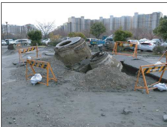
写真1 浮き上がった防火水槽のマンホール（千葉県浦安市） （平成23年（2011年）東北地方太平洋沖地震現地調査報告より）
