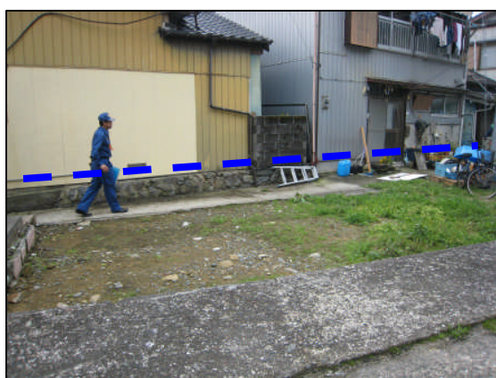
3 : 崎津での床下浸水 (0.6m)
