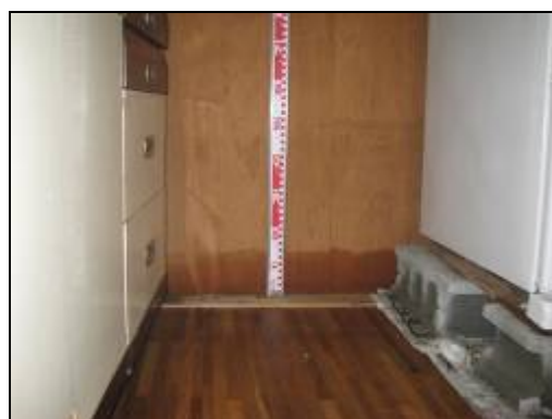
家屋内の浸水状況（地点3） 7月16日14時頃
