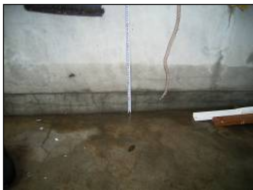
消防署上県出張所車庫の浸水状況（地点1） 7月15日15時30分頃 （写真提供：対馬市消防署上県出張所）
