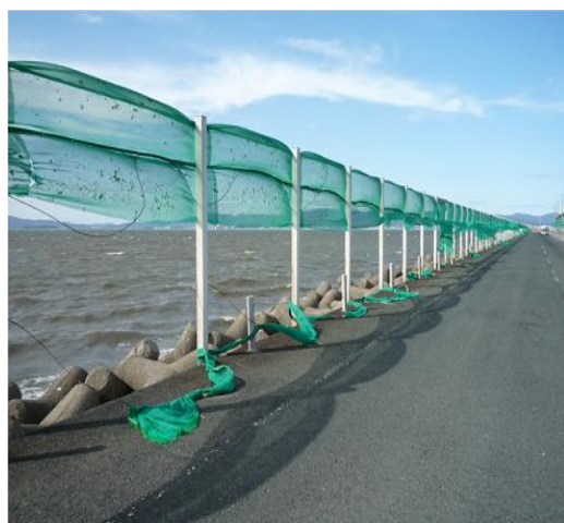
(A-④) 破れたネット(撮影方向:左が西側)
