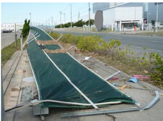
(A-③) 風か海水で倒れたフェンス
