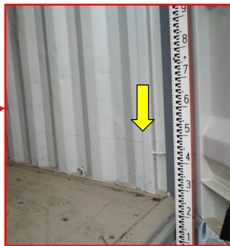
痕跡の測定 (オ) (左写真の丸枠の扉の内側)
