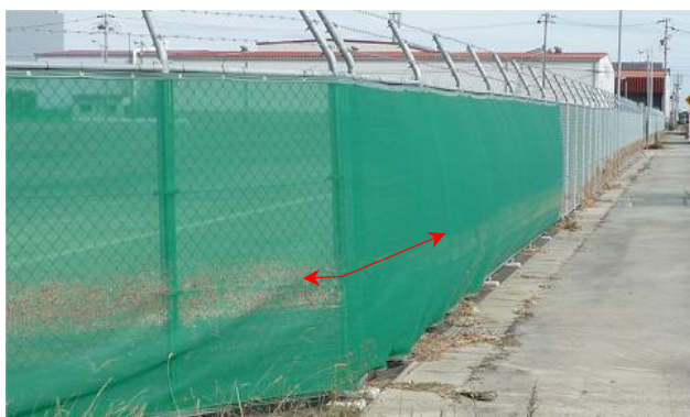
(A-②) フェンスに残された浸水の痕跡
