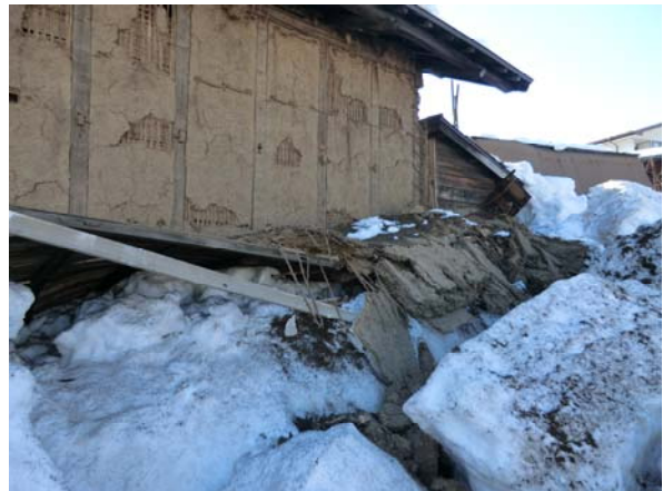
写真 1 6 土蔵の外壁剥離及び倒壊 (長野県栄村)
