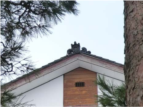
写真3 3 屋根瓦（鬼瓦）のずれ (新潟県上越市三和区井ノ口)
