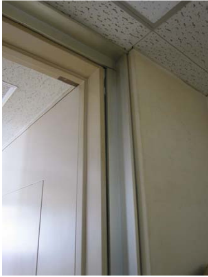
写真23 庁舎ゆがみのためドア部分に 生じた隙間 (新潟県十日町市水口沢)
