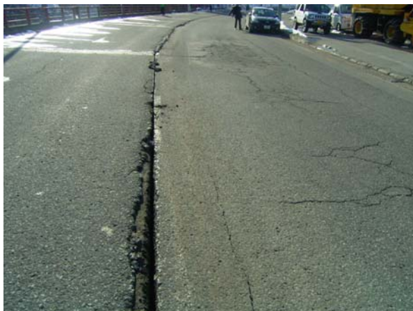
写真 1 7 国道 1 1 7 号線の地割れ (長野県栄村)
