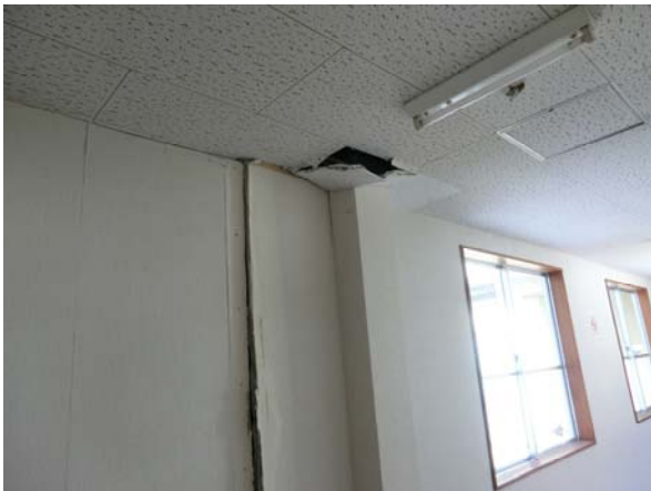
写真3 十日町市上山中里公民館天井の剥離 (新潟県十日町市上山中里)
