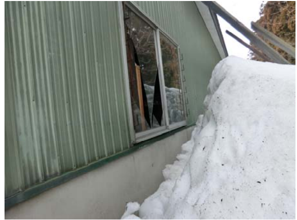
写真3 4 倉庫のガラス割れ (新潟県上越市三和区井ノ口)
