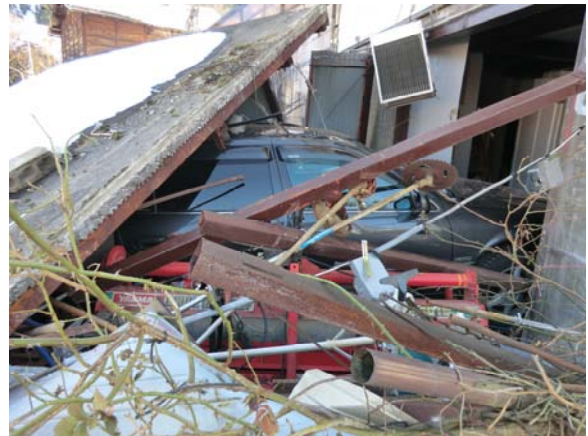
写真 1 4 民家の車庫の倒壊 (長野県栄村)
