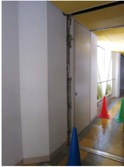
写真 1 9 松代中学校体育館の壁の亀裂 (新潟県十日町市松代)
