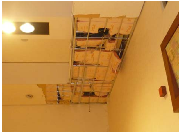
写真2 十日町市上山の多目的ホール天井の 破損、落下・写真1の拡大 (新潟県十日町市上山中里)
