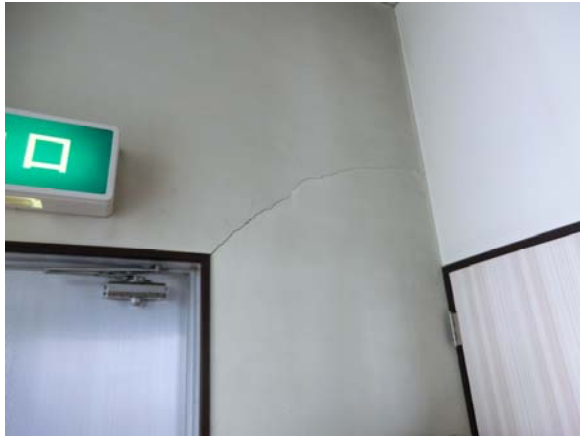
写真3 1 福祉施設の内壁ひび割れ (新潟県上越市三和区井ノ口)
