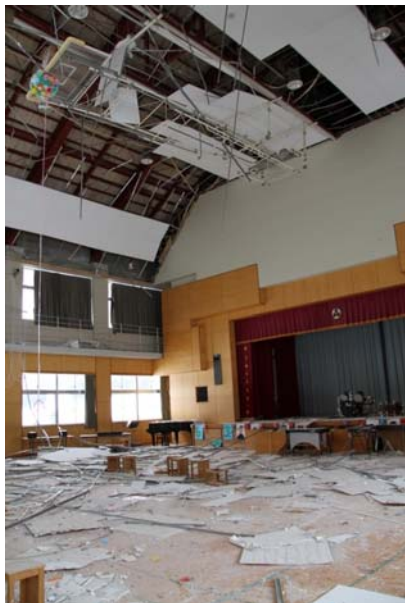
写真9 上郷小学校 天井パネルの落下 (新潟県津南町：津南町提供)
