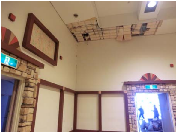
写真1 十日町市上山の多目的ホール天井の 破損、落下 (新潟県十日町市上山中里)
