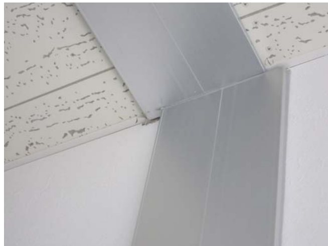
写真26 庁舎のゆがみ 写真3の拡大 (新潟県十日町市水口沢)
