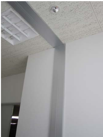
写真25 庁舎のゆがみ (新潟県十日町市水口沢)
