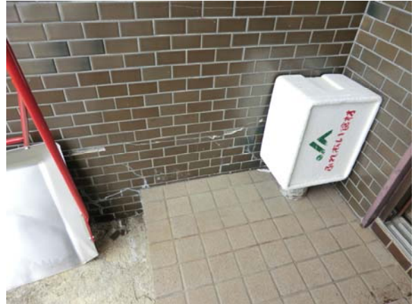
写真3 2 民家の玄関側壁のひび割れ (新潟県上越市三和区井ノ口)
