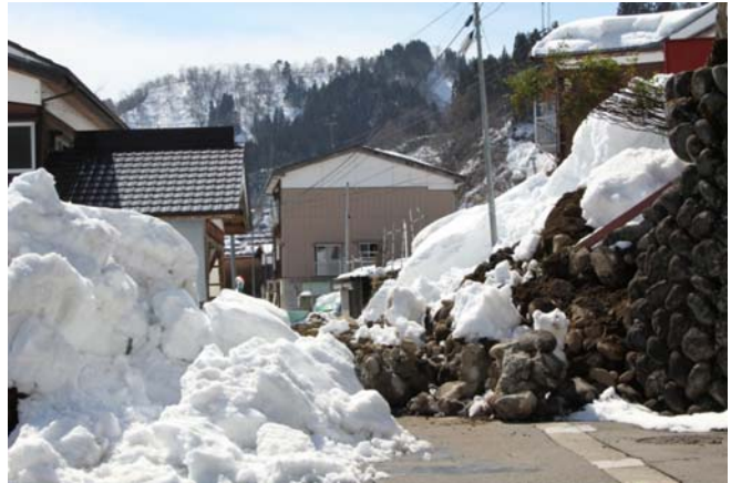
写真8 津南町小島 石垣の崩落 (新潟県津南町：津南町提供)
