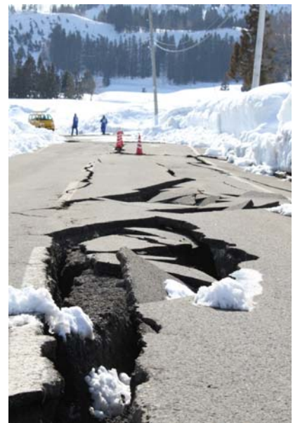
写真12 津南町上野 道路の地割れ (新潟県津南町：津南町提供)
