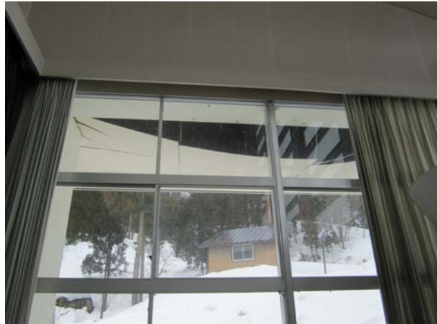
写真 2 0 松代中学校体育館のひさし部分の落下 (新潟県十日町市松代)
