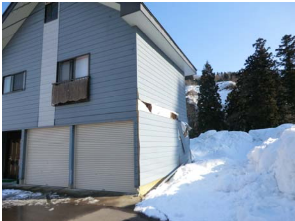
写真 1 5 民家外壁の剥離 (長野県栄村)
