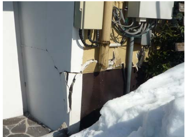
写真4 十日町市上山中里の住家外壁の亀裂、剥離、 (新潟県十日町市上山中里)
