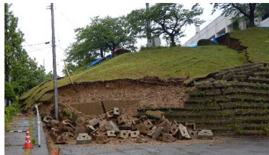
写真2 のり面の一部崩壊
