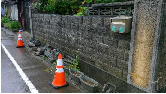
写真3 ブロック塀上部の崩落
