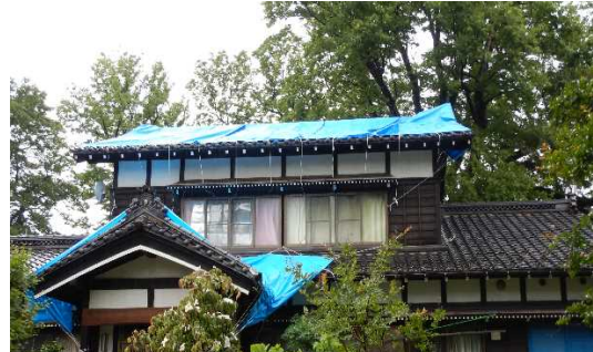
写真6 家屋の屋根瓦の崩落
