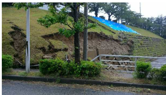
写真1 のり面の一部崩壊
