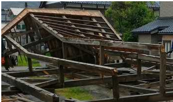
写真7 駅前の駐輪場の倒壊
