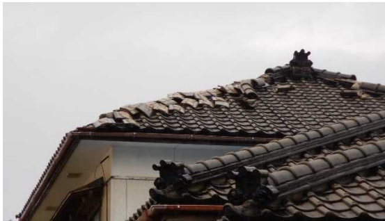
写真5 家屋の屋根瓦の崩落
