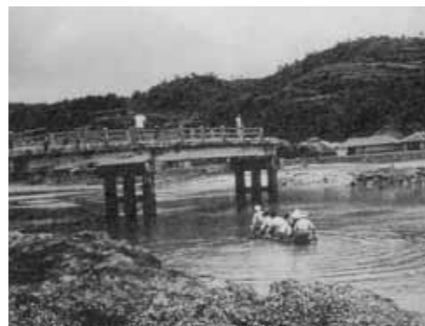
1960年5月チリ津波によって破壊された久志村大浦橋（沖縄県災害誌より）
