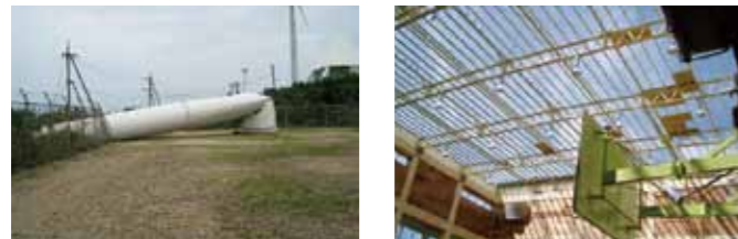
平成 15 年台風第 14 号 (マエミー) による宮古島での被害
