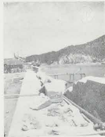
護岸の破損 (香川県大川郡引田町) (高松地方気象台撮影)
