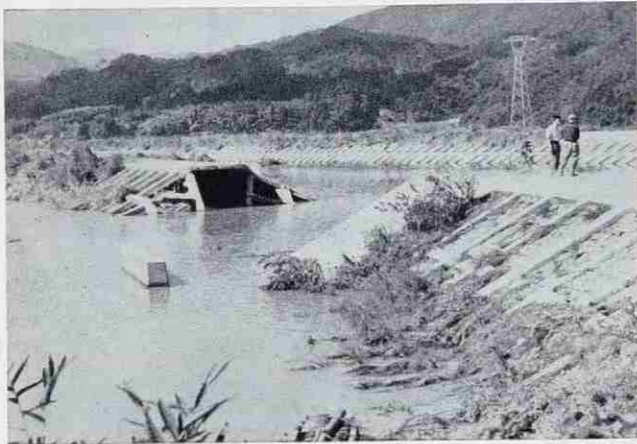
豊岡市森津奈佐川堤防の決壊現場 (豊岡測候所撮影)
