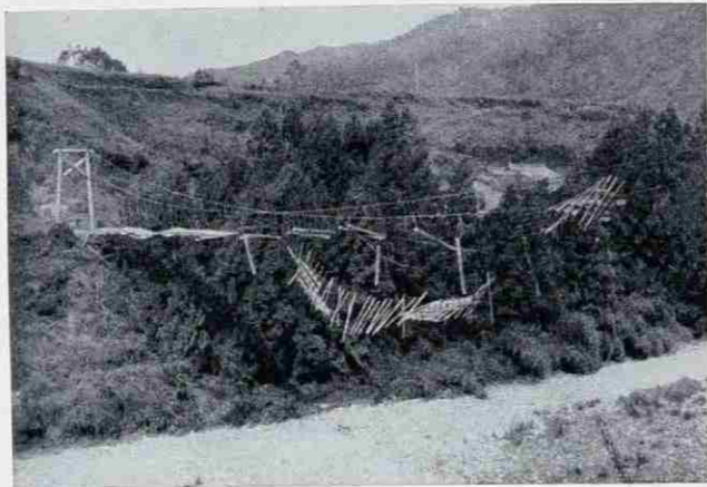
強風で破壊された吊橋 和歌山県古座川町 (潮岬測候所撮影)
