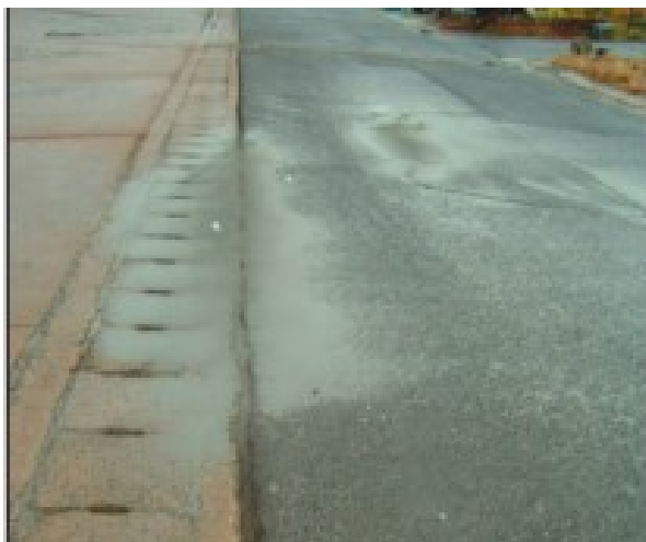
写真 1 道路亀裂、泥水（砂水）噴出 （写真は気象庁技術報告第 130 号）
