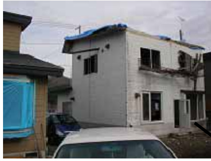
屋根が飛び、壁に木がささっている住家
