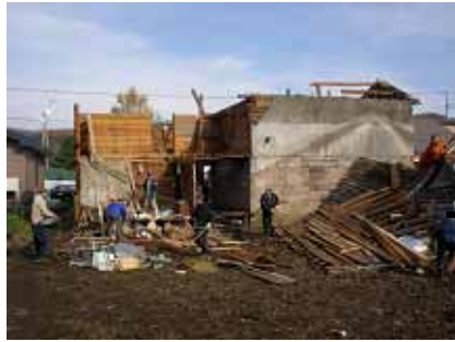
屋根及び壁が飛んだ倉庫
