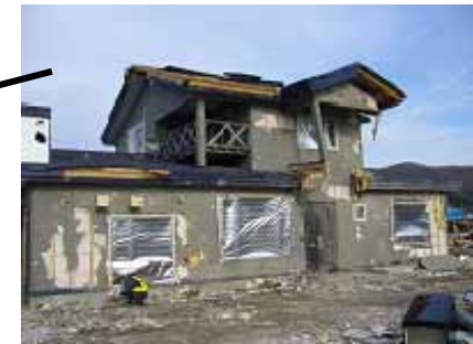
損壊した食堂 手前にあった物置は全壊し、片付けられている
