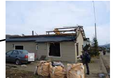
屋根が飛んだ住家兼事務所
