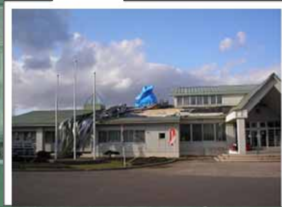
屋根が剥離した若佐コミュニティセンター
