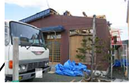
屋根が飛んだ住家
