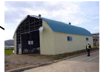
入り口シャッターが飛ばされた農耕具用倉庫
