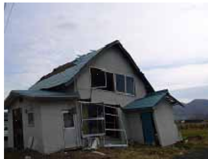
屋根が飛び傾いた空家
