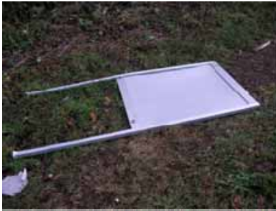
アルミ製ドア（破損、ガラスが無い）
