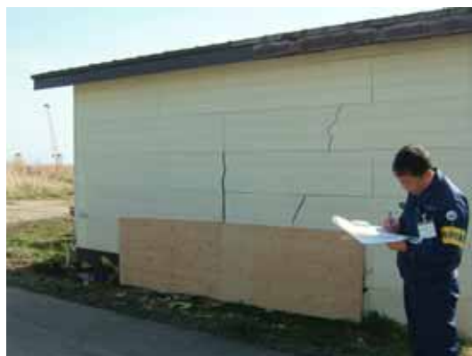
図 3-4-5 飛来物により破損した Dさん宅の外壁
