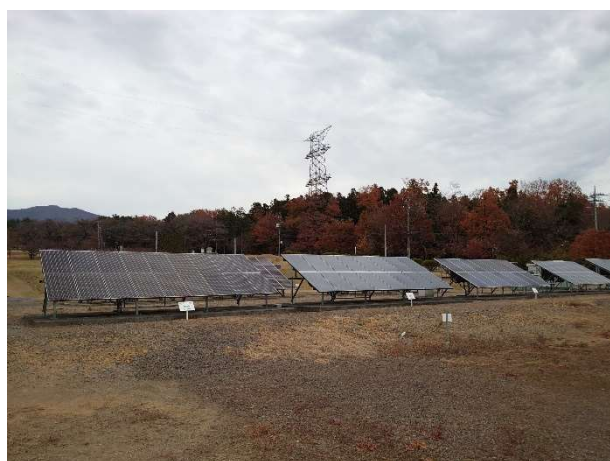
太陽光発電設備
