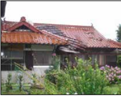
[11] ひさしが破損し、屋根の瓦がめくれた住家(撮影方向:東)【美祿市提供】
