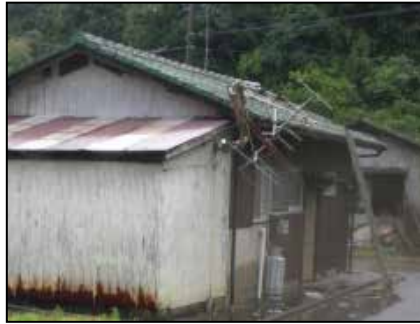
[12] アンテナが折損し、屋根が一部損壊した住家(撮影方向:南西)【美祿市提供】
