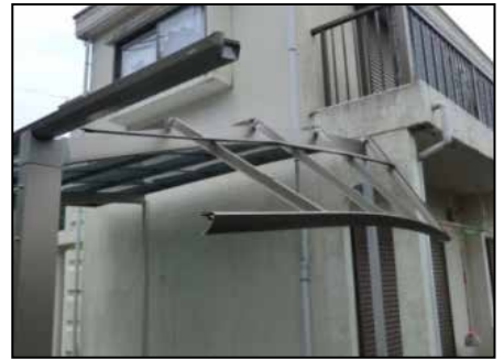
[16] 破損したアルミ製のカーポート(撮影方向:北東)
