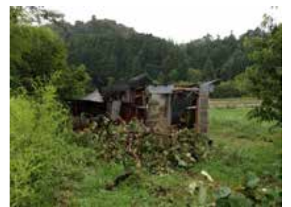
[9] トタン屋根が剥離した倉庫(撮影方向: 北)
