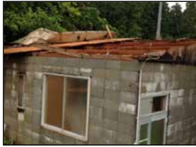
[2] トタン屋根が飛散した非住家(撮影方向: 北西)
