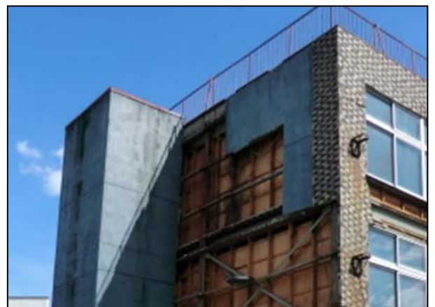
写真6 西富士宮駅付近（震度観測点・富士宮市弓沢町より西へ約1.7 km）の店舗壁面の損壊
