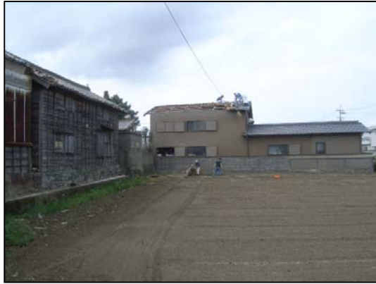
④ 屋根材が剥ぎ取られた家屋。
