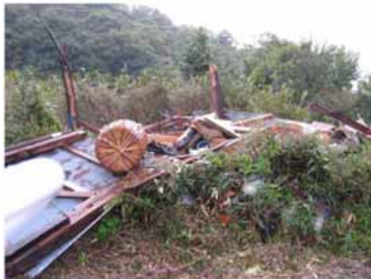
岩美町岩本 小屋が倒壊している。(岩美町提供)
