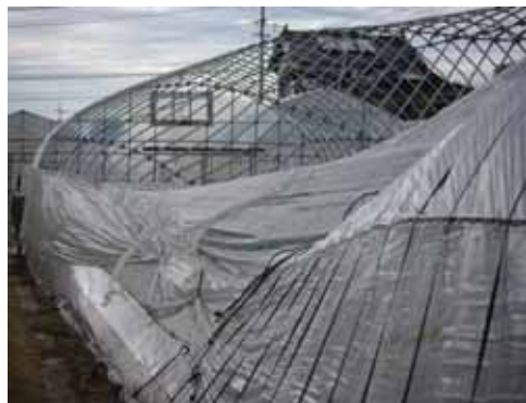
日吉津村日吉津 ビニールハウス (同左) の損壊
