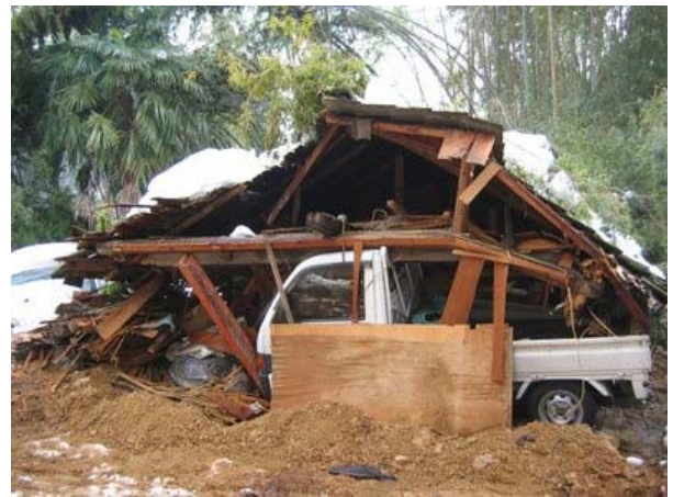
写真 2 農機具庫倒壊 (八頭町、横壁撤去後のもの)
