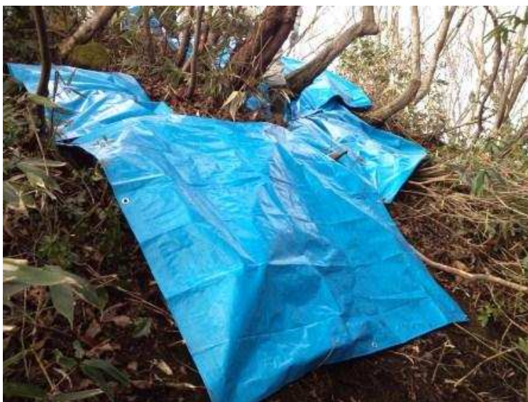
図3：飛散防止のためのブルーシートによる応急処置の状況
