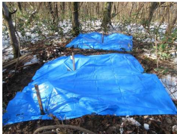
図3：飛散防止のためのブルーシートによる応急処置の状況
