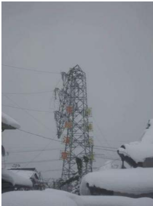
折れ曲がった送電線鉄塔（中国電力提供）
