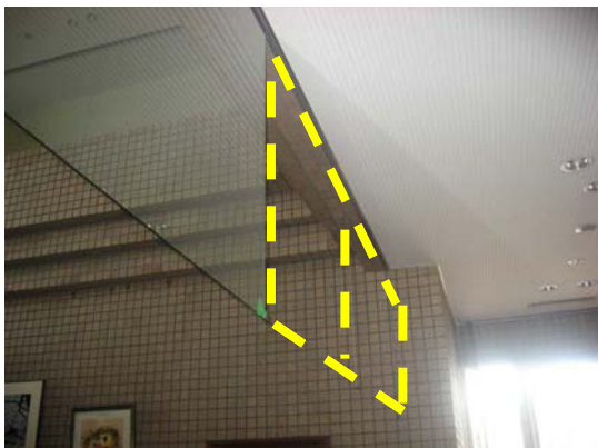
写真4 広川町役場庁舎内の防煙ガラスの一部破損（破線部）
