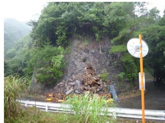
写真5 高津尾川上流の県道196号線でがけ崩れ
