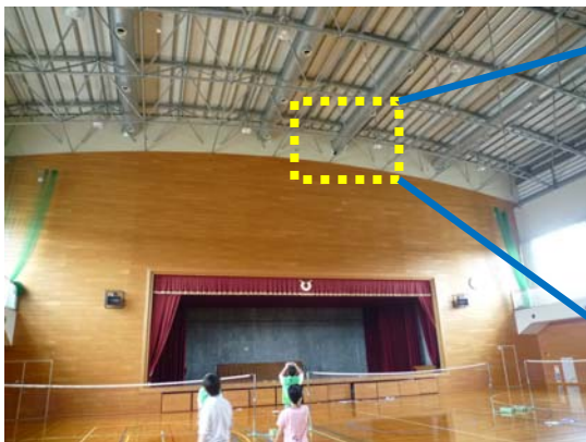
写真3-1 広川町民体育館内の壁が剥落
