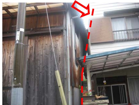
写真2 湯浅地区の倉庫が住宅側（南側）に傾斜（矢印部分）
