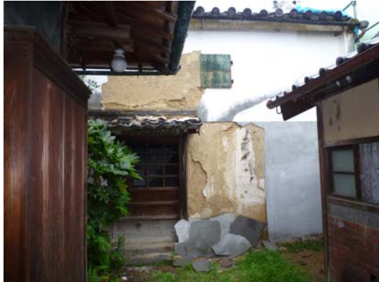
写真1 湯浅地区の蔵の土壁が剥落
