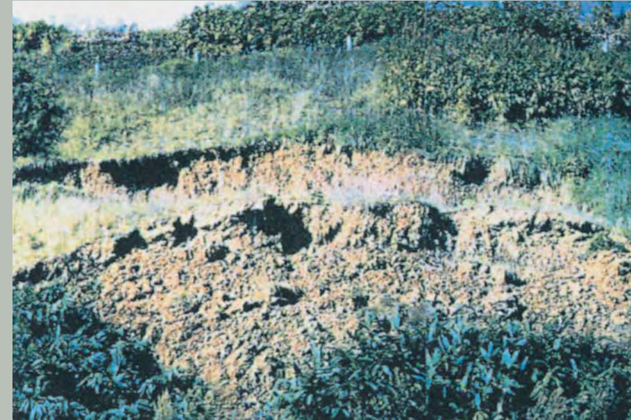
枝幸町歌登の上毛登別線法面崩壊現場（枝幸町提供）
