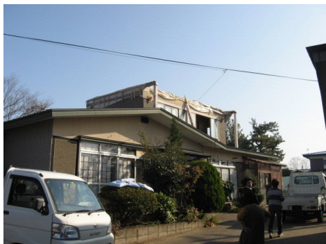
二階屋根が飛ばされた住家
