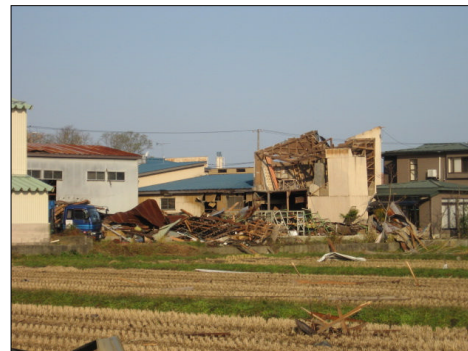
半壊した作業所
