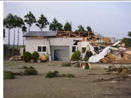
半壊した作業所
