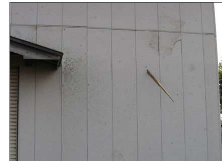
倉庫外壁に食い込んだ飛翔木材
