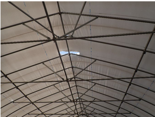
⑤パイプハウスのビニル屋根のはく離
