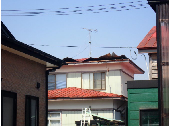
①木造住宅のトタン屋根のはく離 (南から撮影)
