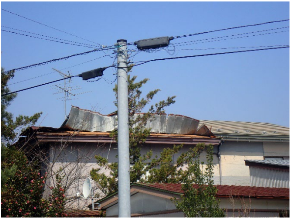
③木造住宅のトタン屋根のはく離 (南東から撮影)
