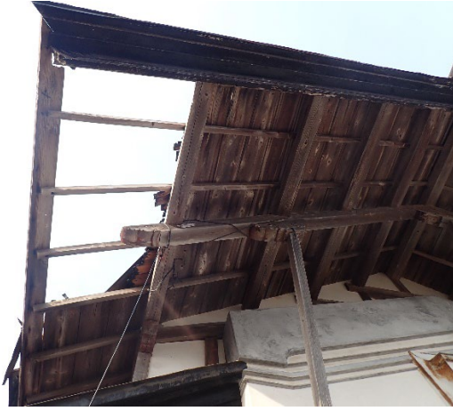
⑦木造非住家の屋根の構成部材の飛散
