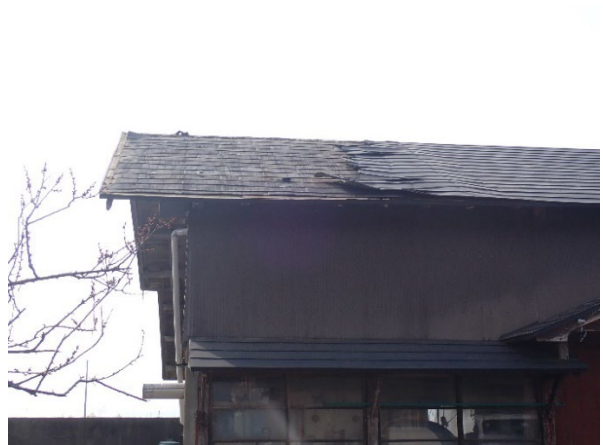
⑥木造非住家のトタン屋根のはく離
