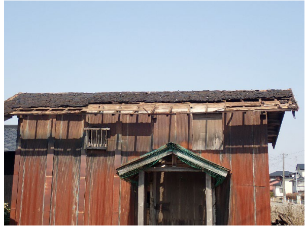
②木造非住家のトタン屋根のはく離 (南から撮影)
