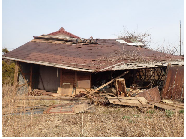
⑧木造非住家の上部構造の著しい変形
