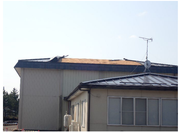
④木造の非住家(集会所併設の体育館)のトタン屋根のはく離 (北から撮影)
