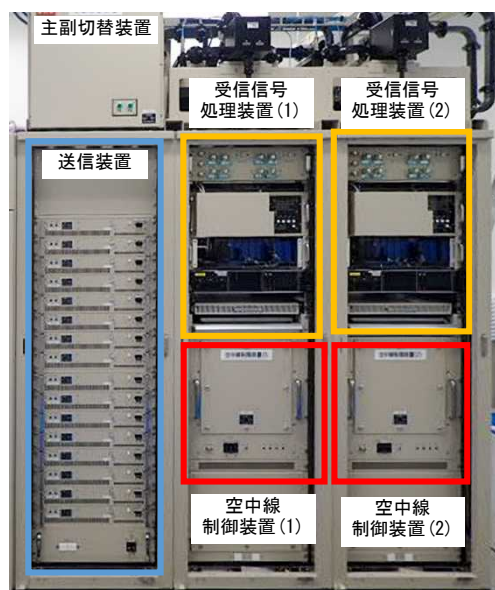
第4図 レーダー装置本体部 電波を作る送信装置や、受信電波を処理する受信信号処理装置などの機器で構成されています。
