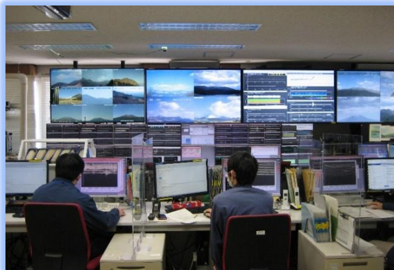
福岡管区気象台内にある火山監視をする「現業室」
