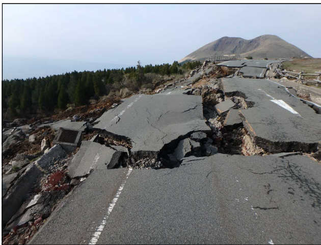
平成28年（2016年）熊本地震で崩れた道路 （熊本県南阿蘇村中松）
