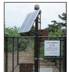
GNSS観測装置
