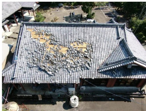
① 住家の屋根瓦の飛散及び野地板の破損
