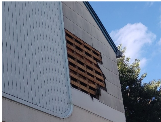
③ 体育館の外壁の被害
