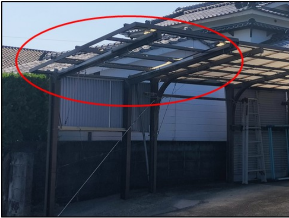
① カーポートの屋根パネルの破損
