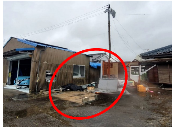
② 非住家建築物の上部構造の倒壊 (写真は倒壊した建築物が片付けられた後の様子)
