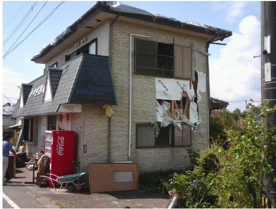
① 住家の外壁材のはく離
