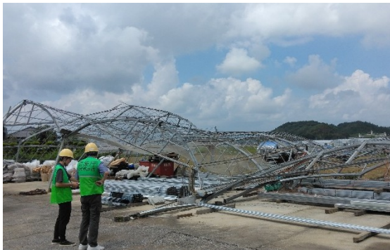
③ ビニールハウス型の車庫の倒壊
