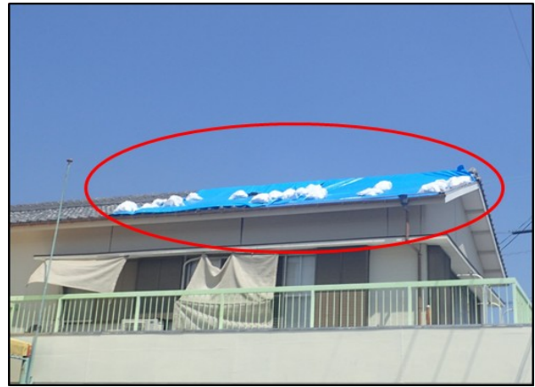
② 住家の屋根ふき材のはく離
