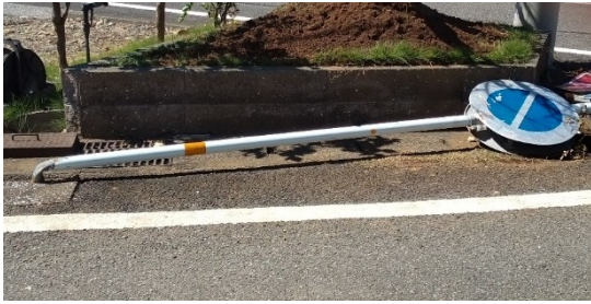
① 道路交通標識の支柱の倒壊
