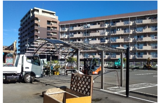
② カーポートの屋根パネルの破損
