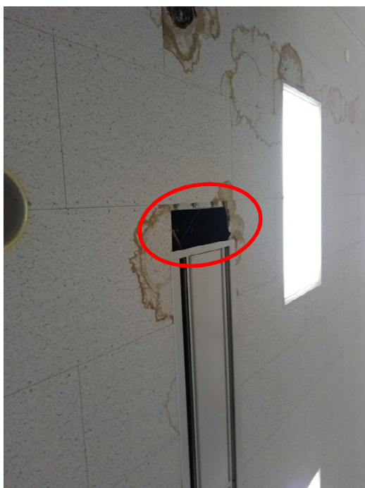
写真3 天井石膏ボード損傷 (日南市中央通)
