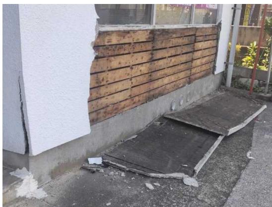
写真1 店舗の壁面剥離 (日南市南郷町)
