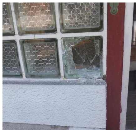
写真2 店舗のガラス破損 (日南市南郷町)
