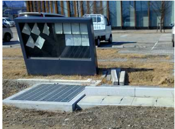
写真4：役場敷地内の屋外掲示版の傾き（福島県国見町）
