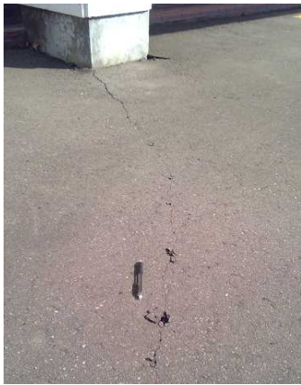
写真1：庁舎入り口付近のアスファルト路面に亀裂（宮城県蔵王町）
