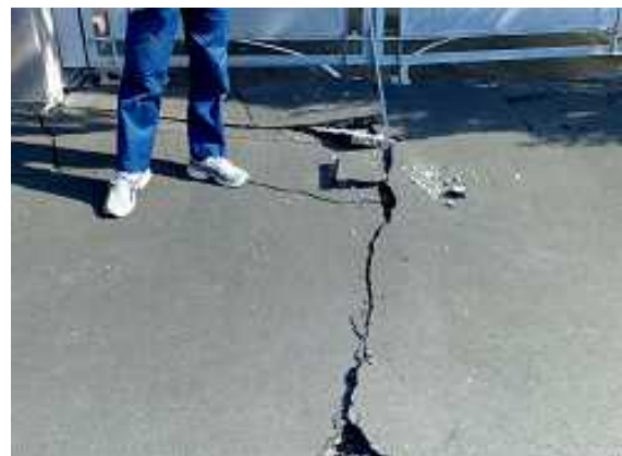
写真6：観測点周辺施設の門扉前の舗装割れ（福島県相馬市）
