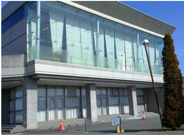
写真9：図書館のガラスの破損（落下）（福島県新地町）
