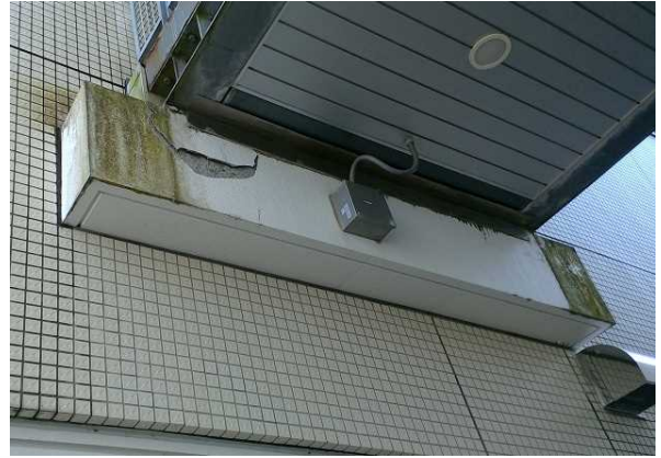
写真8：庁舎外壁のモルタル剥離（福島県新地町）
