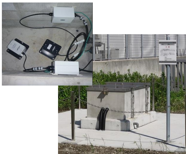
写真1 多機能型地震計（計測部）
