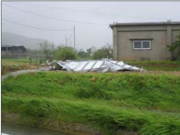
飛散したトタン屋根
