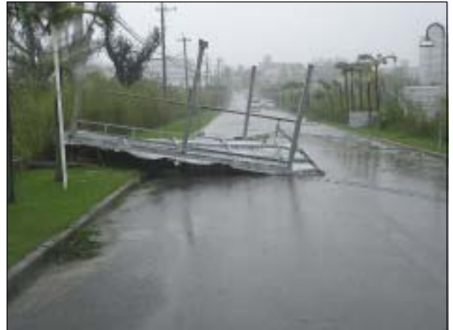
飛散したトタン屋根
