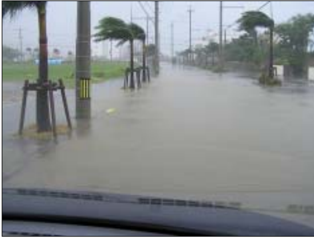
冠水した道路(石垣全日空ホテル&リゾート近く)
