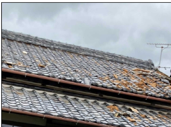
写真①屋根ふき材がはく離した木造の住家 (南側から撮影)
