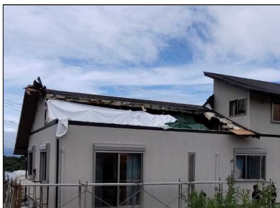
写真②小屋組の構成部材が飛散した木造の住家 (北東側から撮影)
