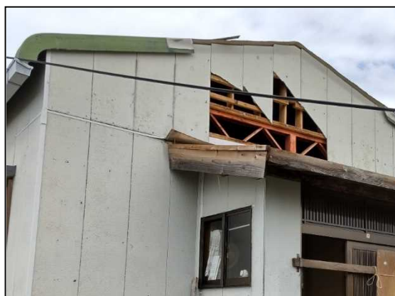
写真③外壁材がはく離した木造の住家 (南側から撮影)
