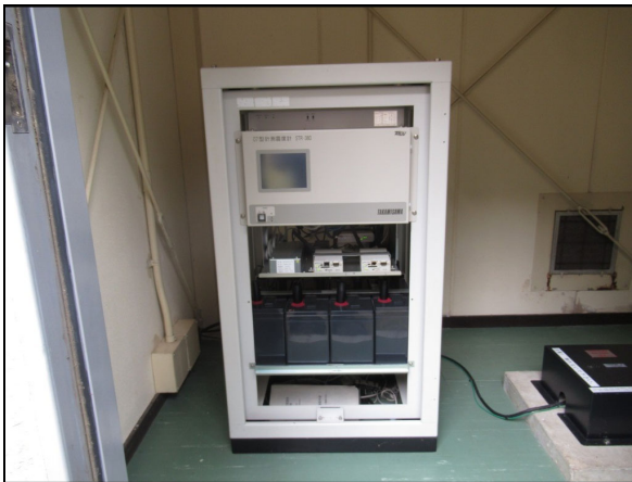
屋内に設置された震度計 大きな地震が発生すると、土台のコンクリートや、周囲の建物に被害が無いかを調べる
