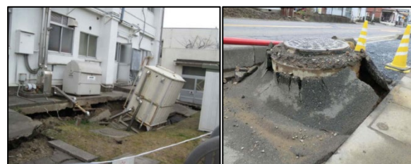
地盤沈下による水槽の傾き 歩道が陥没しマンホールが浮上 (出典：気象庁 災害時地震・津波速報)
