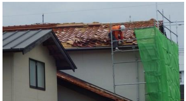
⑥ 屋根瓦がめくれて落下した住家
