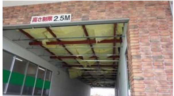
② 天井が落下した通路
