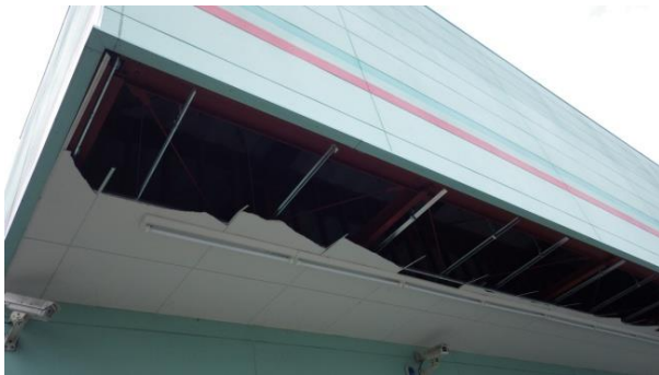
③ 軒天井が落下した店舗
