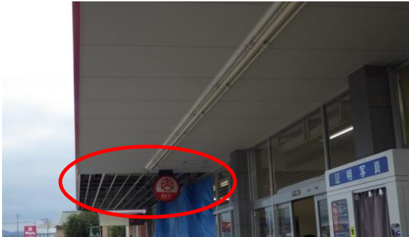
① 軒天井が落下した店舗
