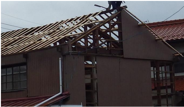
⑨ 屋根が飛散した木造店舗
