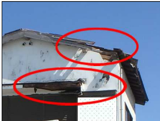
写真 飛散した仮設物による被害を受けた住家
