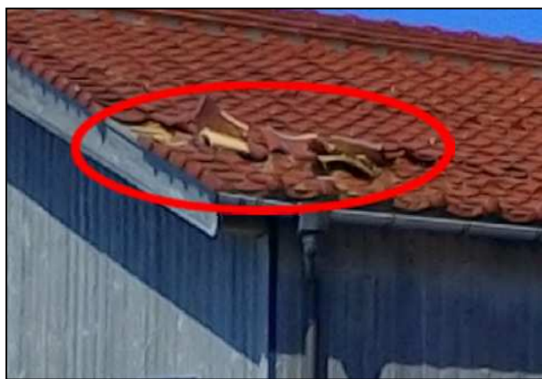
写真 屋根瓦が飛散した住家
