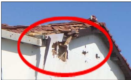
写真 飛散した仮設物による被害を受けた住家
