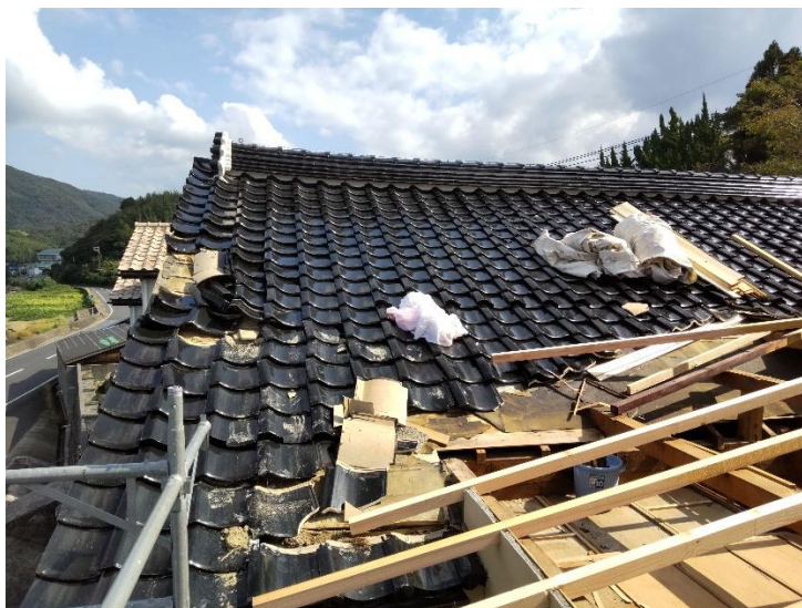
屋根の野地板が飛散した住家（布勢灘地区）
